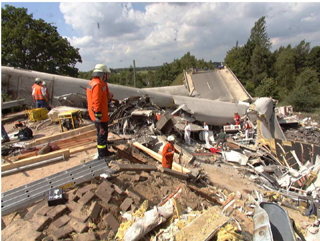
(Eschede: Zustand der Brücke und ein Teil des Zuges nach der Katstrophe am 3. 6. 1998)
